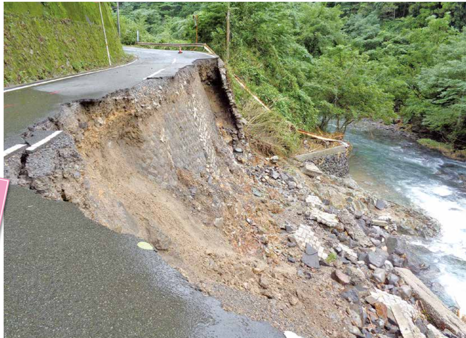
▲令和2年7月豪雨で崩落した大分県日田市の道路【写真提供（一財）消防防災科学センター「災害写真データベース」】
