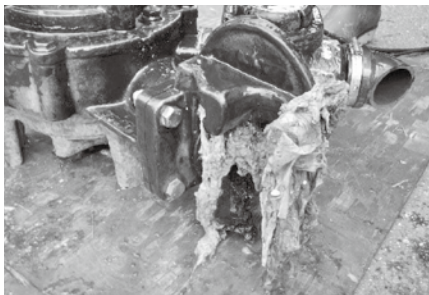
▲下水道設備に詰まった異物
