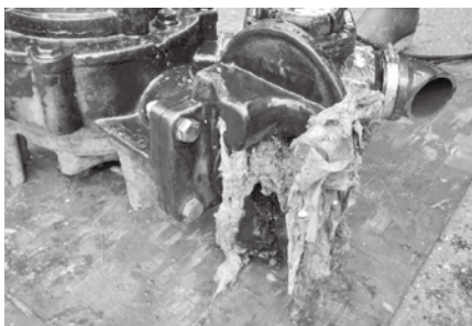
▲下水道設備に詰まった異物
