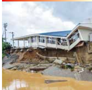
▲川の氾濫によって、護岸が崩落し倒壊した中学校（朝倉市提供）
