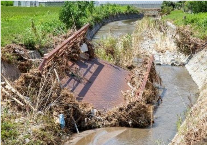
▼本木川1号橋の流出
