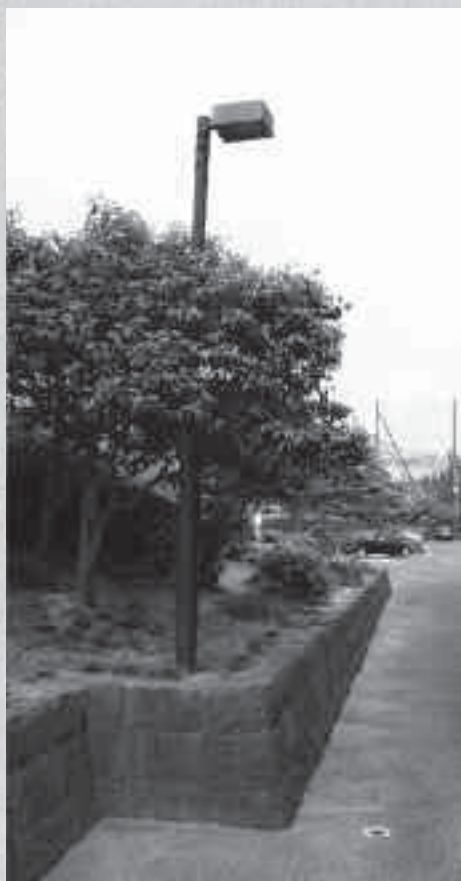
駐車場に通じる道に設置された街灯
