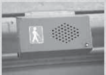
東福岡駅に設置された音声誘導装置
