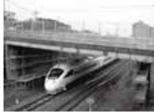
▲損傷が確認されている橋梁の補修工事等を実施します
