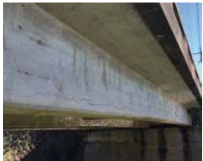
▲コンクリートが老朽化し、ひび割れた橋
