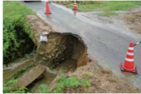
▲小川が増水し、橋の護岸の一部が崩れた
