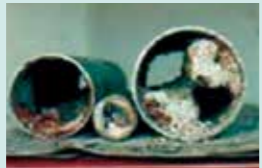
▲油などが付着し詰まった下水道管
