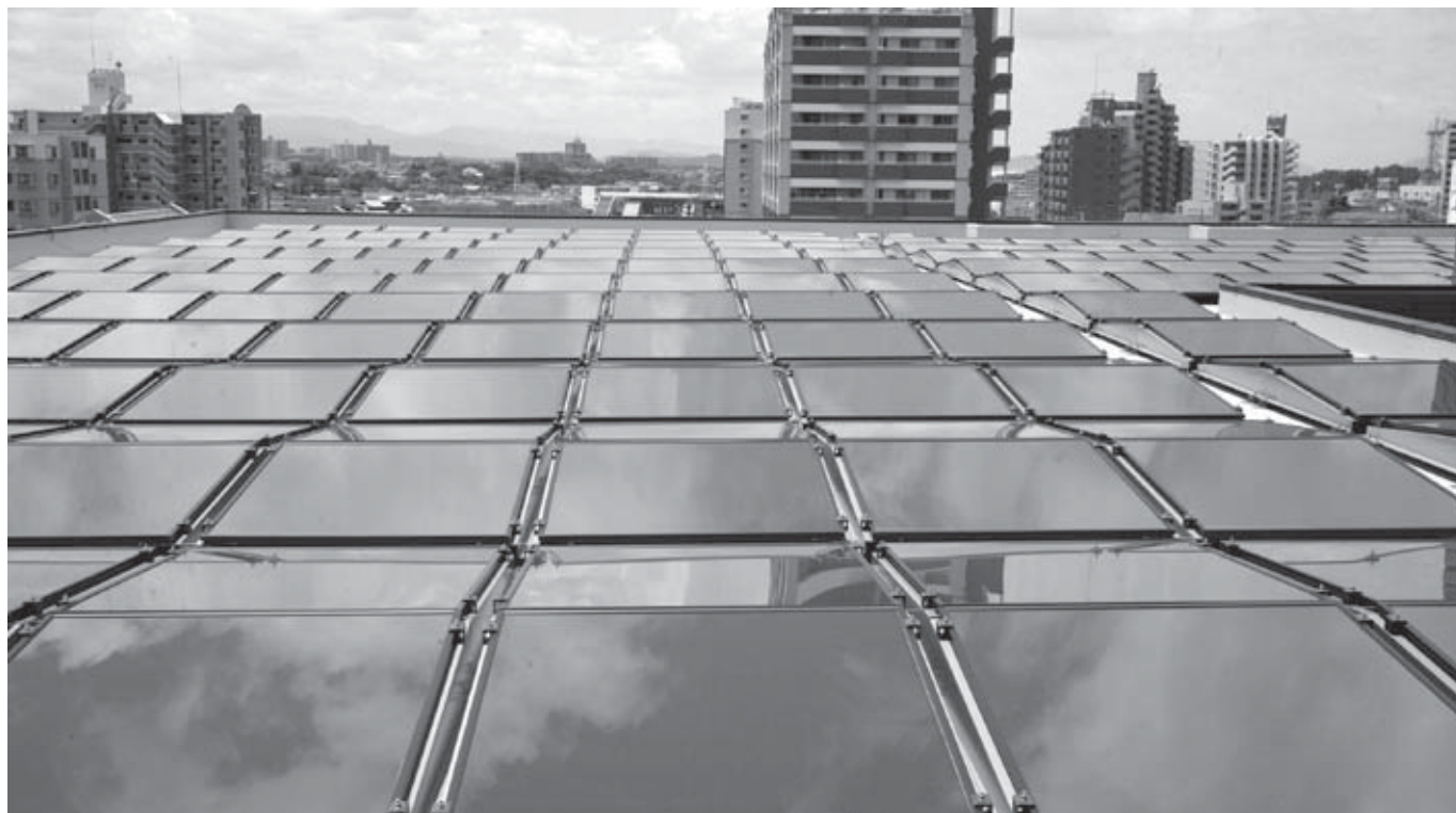
▲国の補助により福間庁舎の屋上で太陽光発電（平成23年3月設置）
