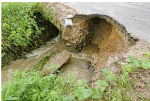
▲手光区の道路が崩れ、一時通行止めに
