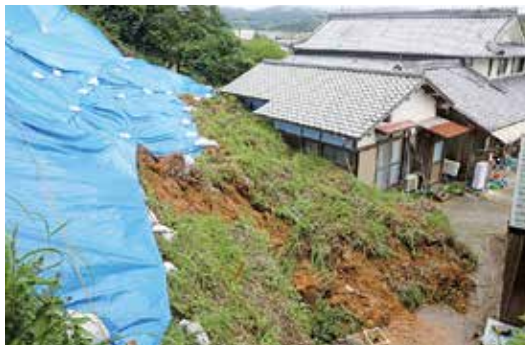
▲土砂が崩れ、市内の民家が被害に
