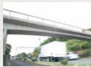
▲1974年建設の国道3号に架かる南天神袴道橋。コンクリートが剥離してきています
