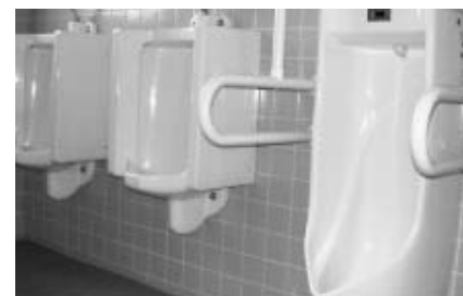
福津市役所「福間庁舎」(床置き式小便器)
