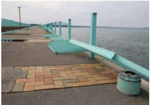
▲台風9号で倒壊した福間漁港海浜公園の柵
