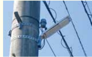
▲街路に設置している防犯灯
