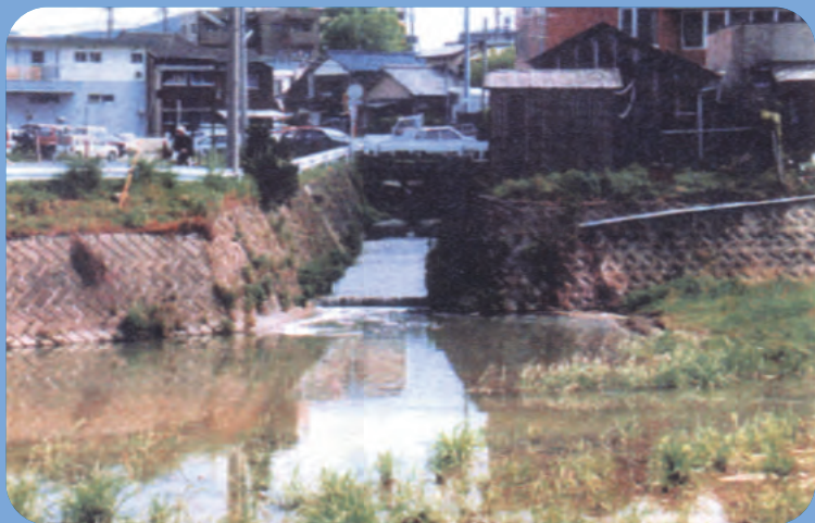
福岡都市下水路の流入地点(平成12年6月撮影)
