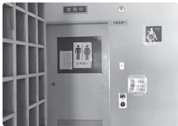
電気がつかない多目的トイレ
