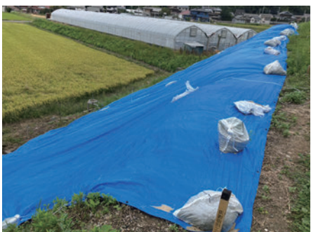
▲被災した辰ヶ鼻ため池の堤体
