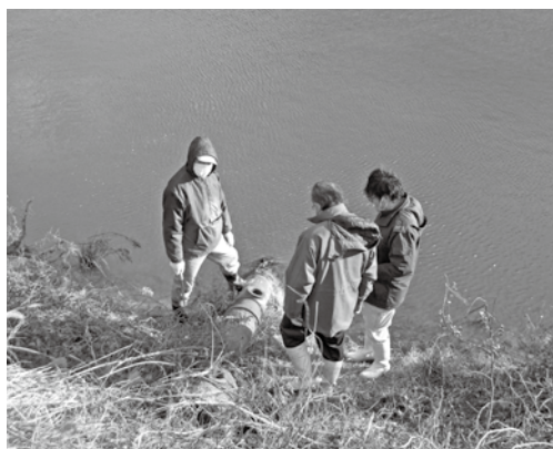
排水施設の破損箇所を調査する市職員
