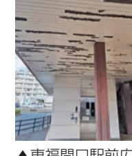
▲東福間口駅前広場側の駅舎の天井の剥離
