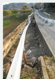
▲大雨で大きく崩落した道路
