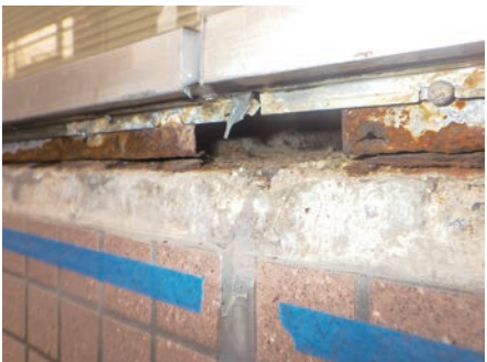
▲工事途中に発見された腐食箇所
