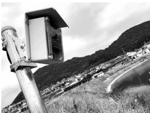
ため池管理システム カメラ部
