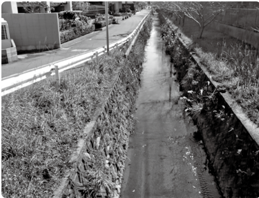
治水対策を（花見地区、井尻川）
