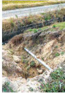
▲復旧が進んでいない大雨で崩落した水路法面
