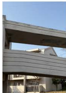
▲連絡通路の塗装の剥離が目立つ市営住宅
