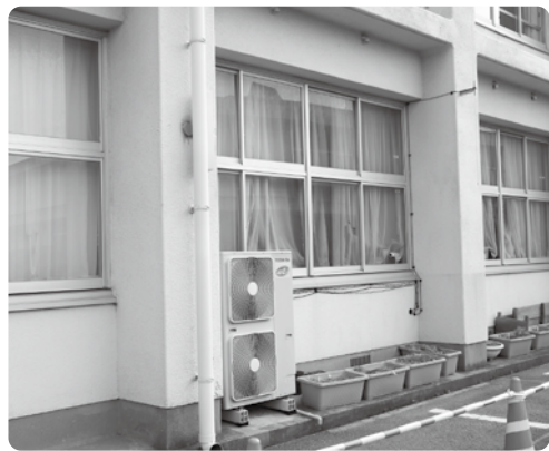
福間小学校に設置されたクーラー
