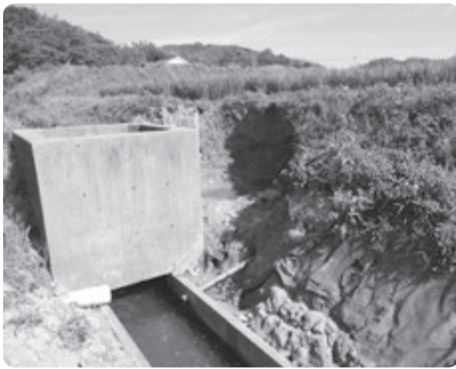
崩壊した法面
