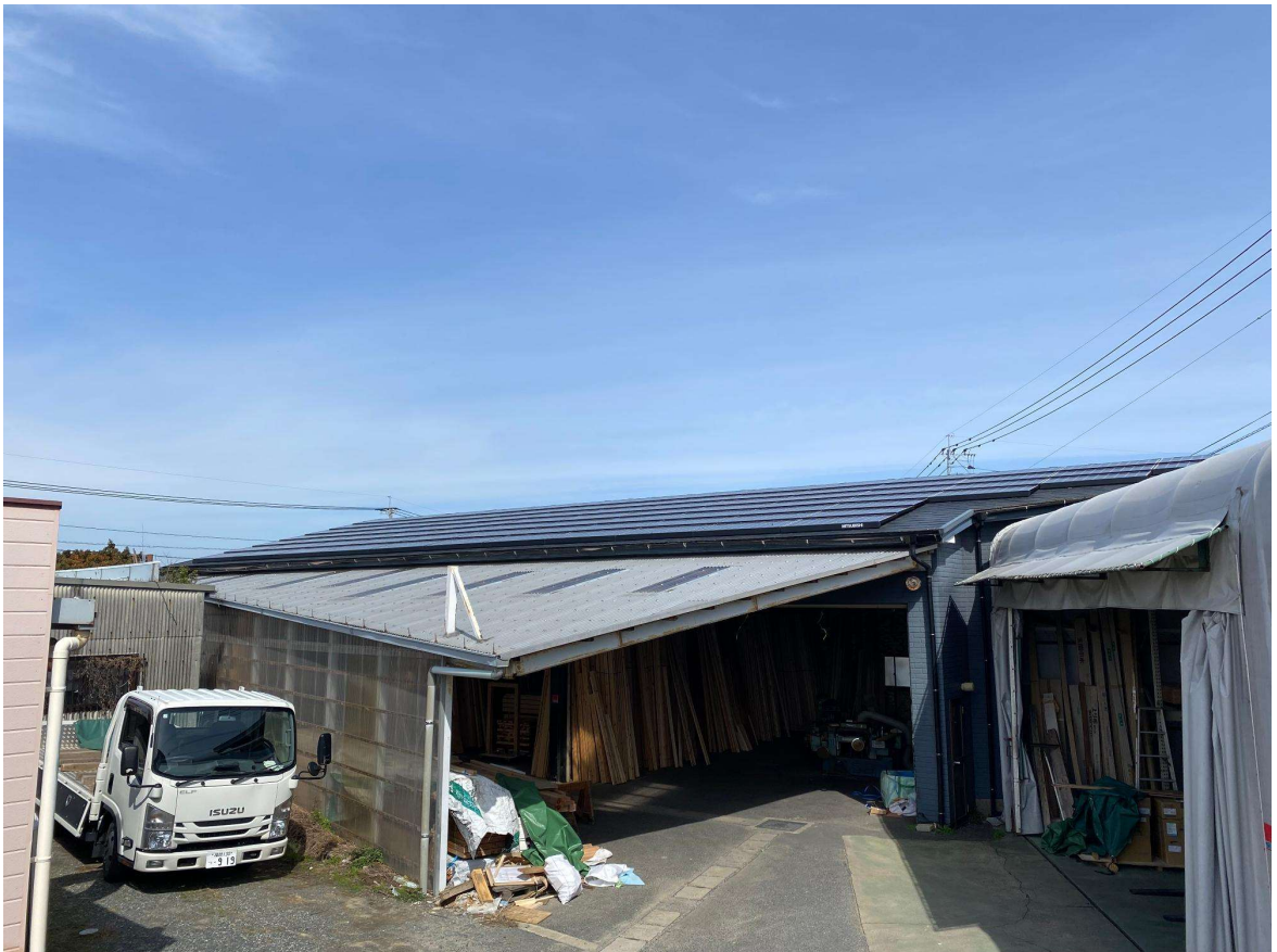
▲屋根に設置された太陽光パネル。1つに見えるが全部で3つに分かれている。
