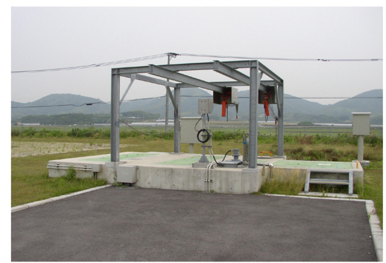
マンホールポンプ
