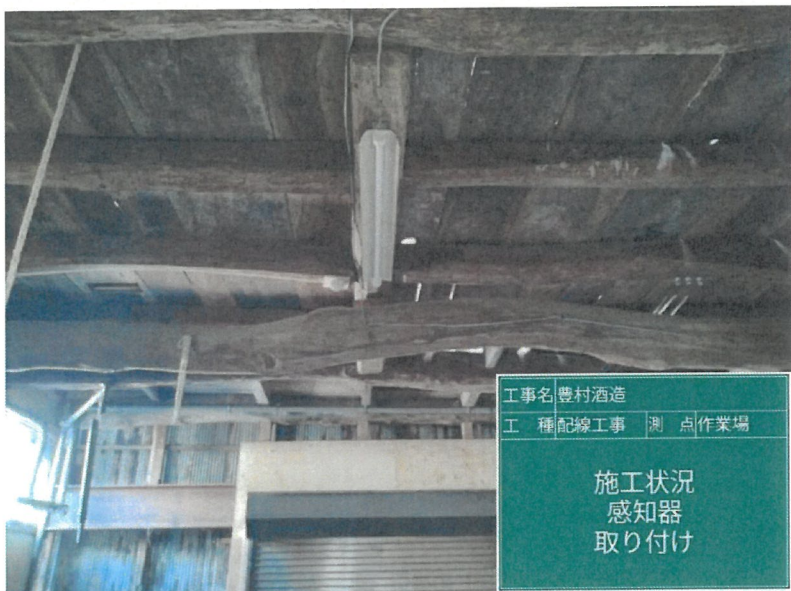
写真3 作業所 感知器設置
