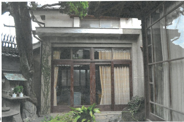
破損時（令和5年7月）状況
