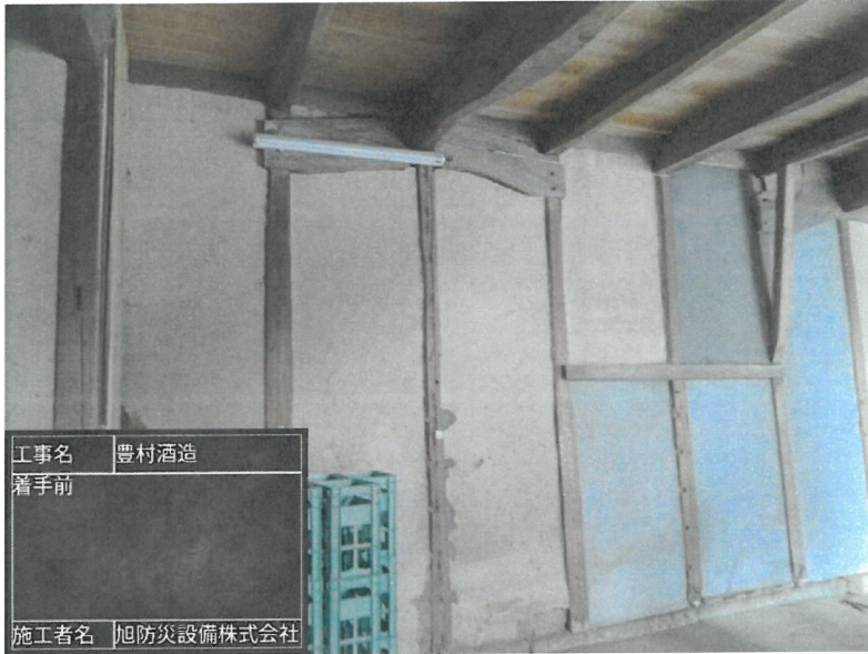
写真7 酒庫 総合盤 施工前
