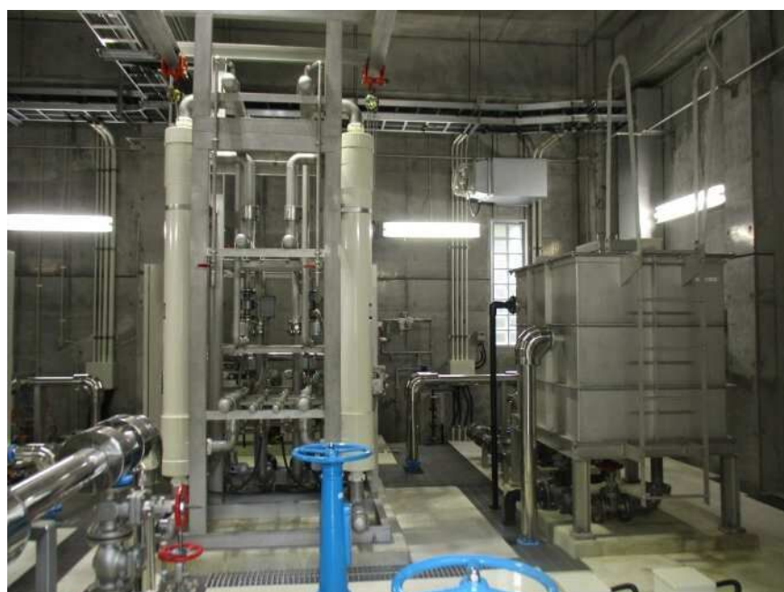
<地島浄水場の内部>
