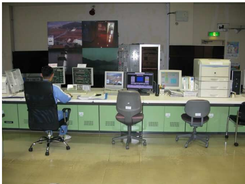
<多礼浄水場 中央管理室>
